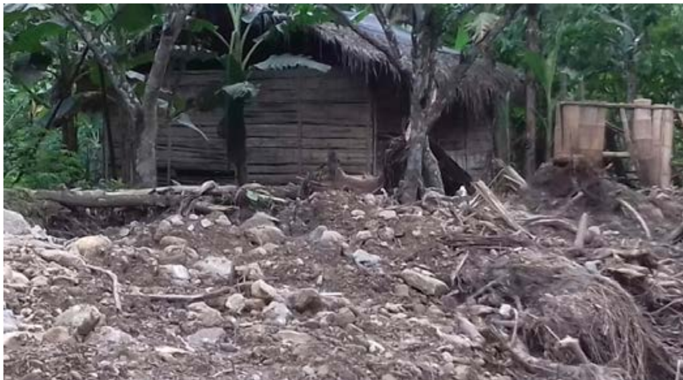
Figura 5.3 Casa dañada por el deslave
