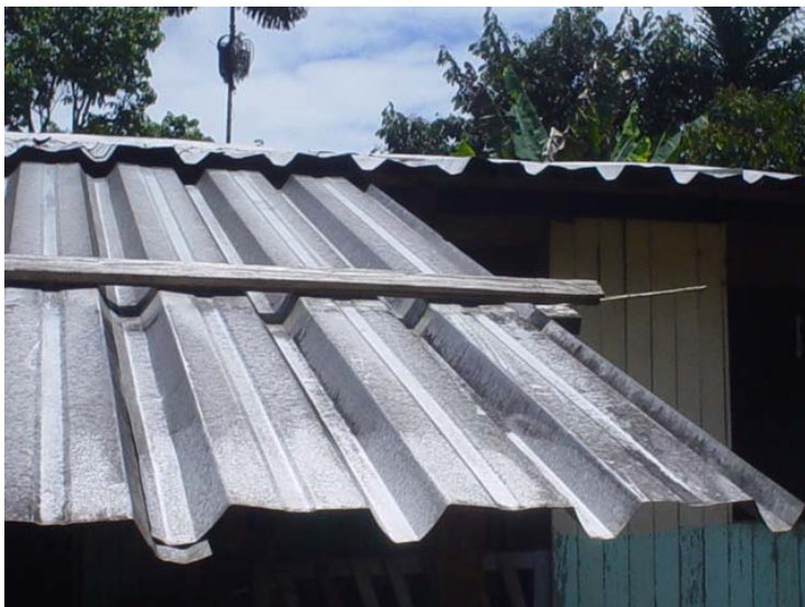
Techo de la casa del Sr. Encalada con restos de hidrocarburos (a 50 m. del CPF)
